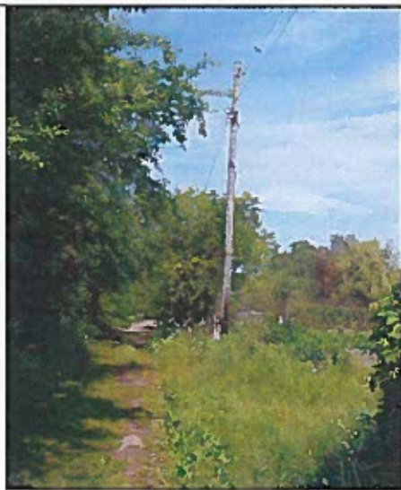
Esošā elektroapgāde Promenādes ielas turpinājuma posmā
