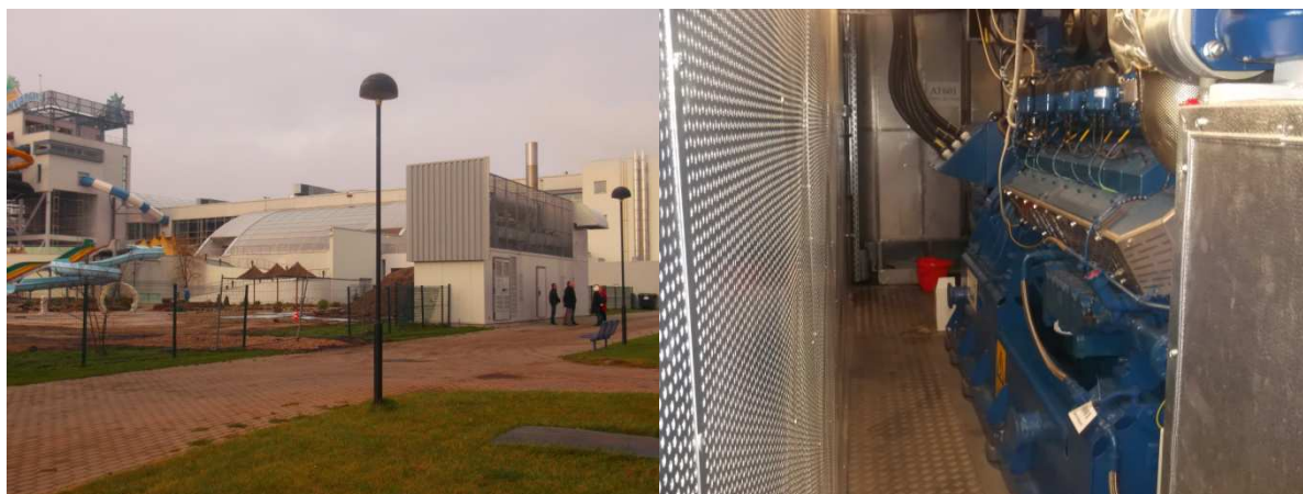
17. ATTĒLS. KOĢENERĀCIJAS STACIJA VIESTURA IELĀ 24 UN IEKŠDEDZES DZINĒJS
