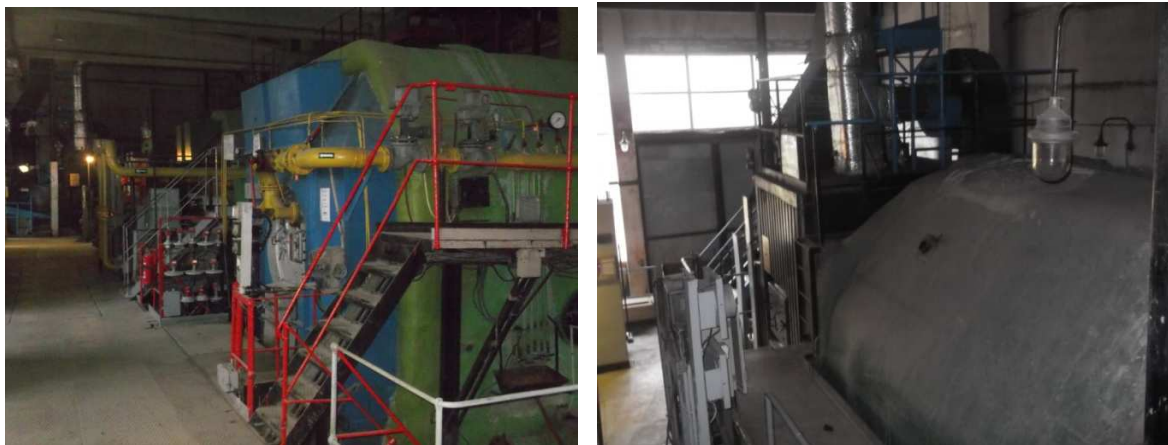
10. ATTĒLS. KATLU MĀJAS SLOKAS IELĀ 47A SIA „JŪRMALAS SILTUMS” GĀZES KATLI (PA KREISI) UN SIA „LKP SOLUTIONS” GĀZES KATLS AR ŠĶELDAS PRIEKŠKURTUVI (PA LABI)
