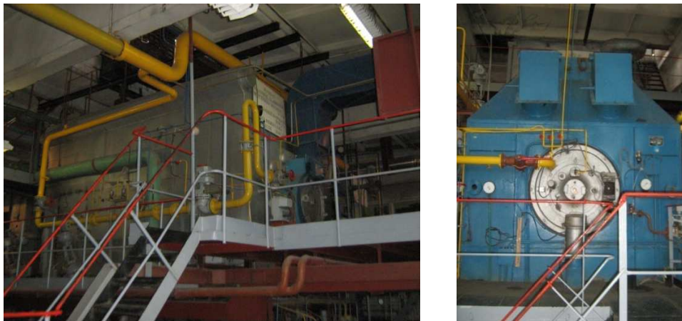
8. ATTĒLS. GĀZES KATLS KVGM-6,5 (PA KREISI) UN GĀZES KATLS KVGM-10 (PA LABI)
