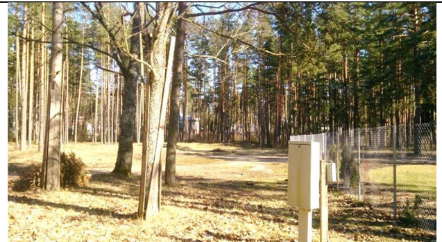
Detālplānojuma teritorija, esošais elektrosadales skapis
