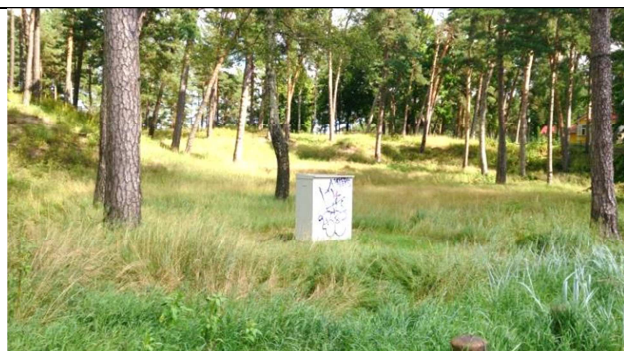
Gāzes regulēšanas punkts zemesgabalā kad.Nr.13000160202
