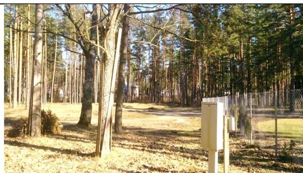
Detālplānojuma teritorija, esošais elektrosadales skapis
