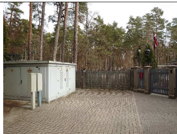
Elektrotransformators pie iebrauktuves zemesgabālā
