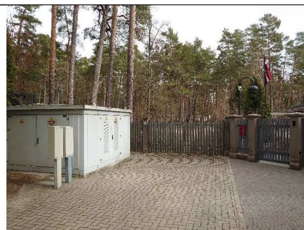
Elektrotransformators pie iebrauktuves zemesgabalā
